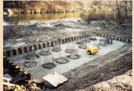
Erstellung der Gründung für die beiden westlichen Brückenpfeiler mittels Bohrpfähle (je Pfeiler acht Bohrpfähle)
